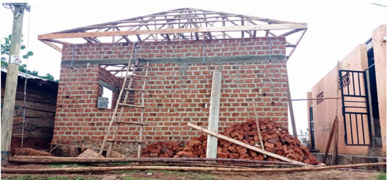
Construcción del nuevo dormitorio en Kiyindi Community School, junto al provisional (izda) y las letrinas Ecosan (dcha).
