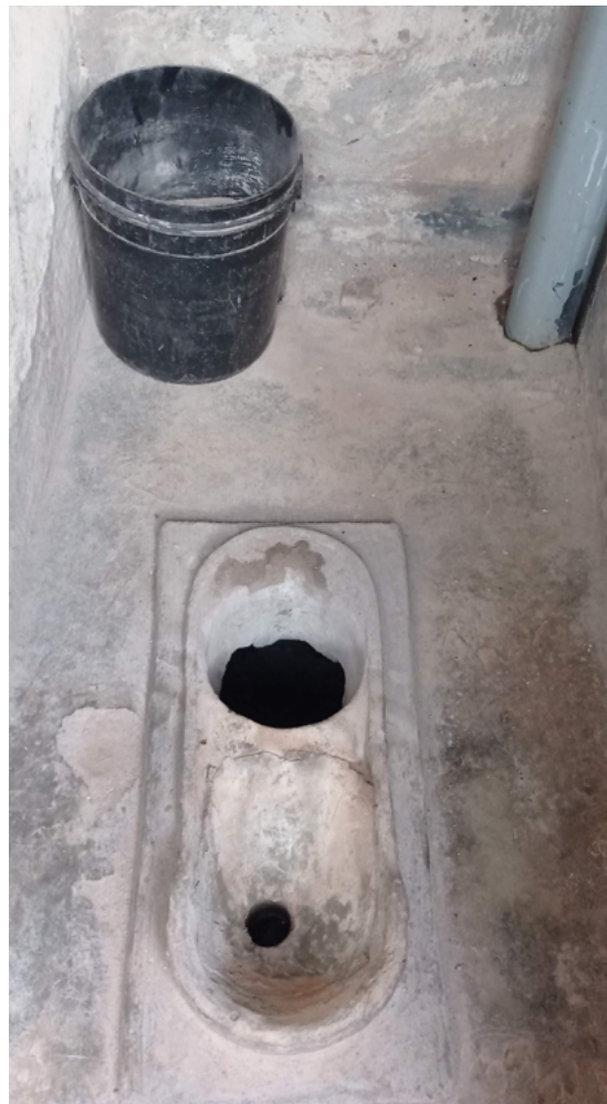
Vista exterior e interior de las nuevas letrinas construidas en Ssenyi Modern School.
